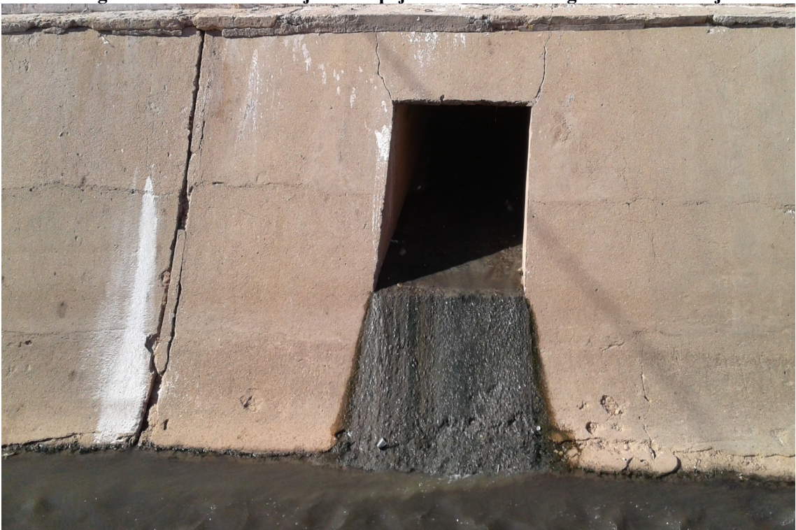
Figura 15 – Resíduos e dejetos despejados no curso de águas do rio Granjeiro
