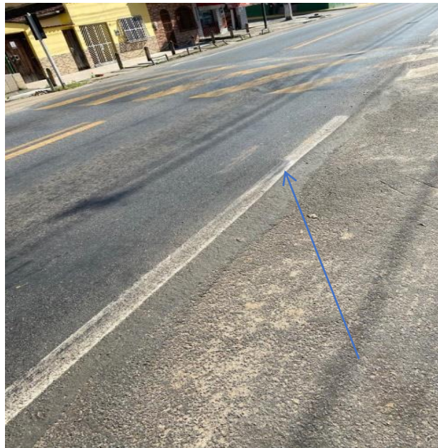
Figuras 05 e 06: Patologia, tipo afundamento plástico.
