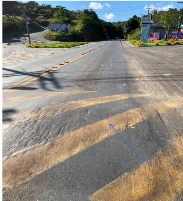
Figuras 05 e 06: Patologia, tipo desgaste.
