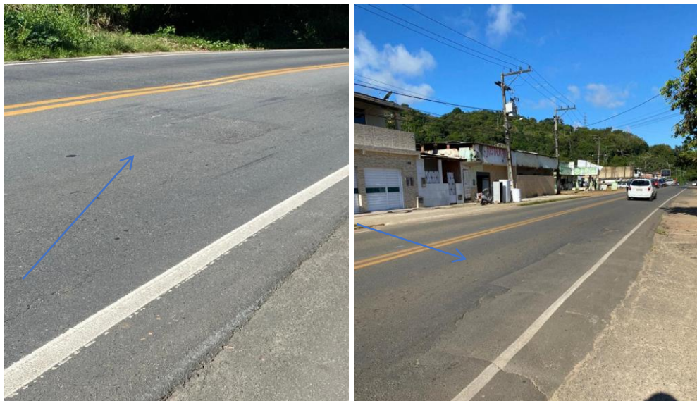
Figuras 05 e 06: Patologia, tipo remendo.
