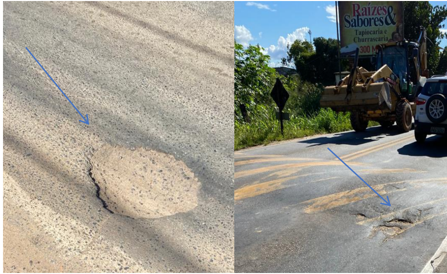
Figuras 04 e 05: Patologia, tipo buraco ou panela.
