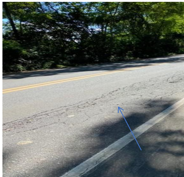
Figura 03: Patologia, tipo trincas tipo couro de jacaré.
